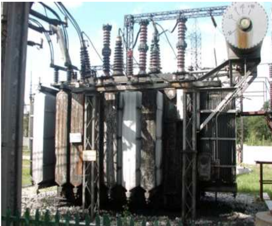
Малюнок 1. Силовий трансформатор на підстанції до проведення реконструкції
