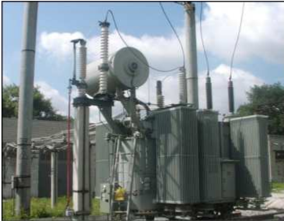
Малюнок 2. Силовий трансформатор на підстанції після проведення реконструкції
