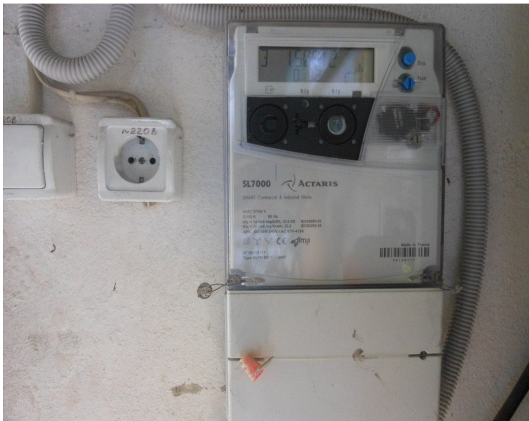
Рисунок 3 – Лічильник електроенергії «Actaris SL7000 Smart»
