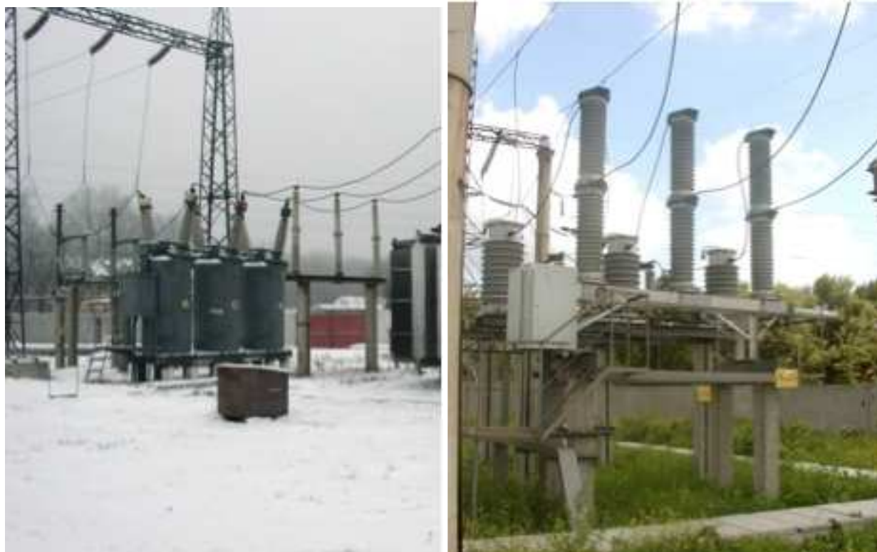
Малюнок 8. Автоматичні вимикачі до та після проведення реконструкції.
