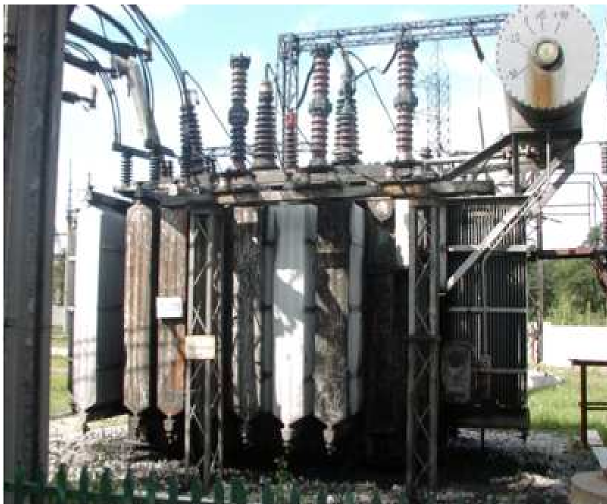
Малюнок 6. Силовий трансформатор на підстанції до проведення реконструкції
