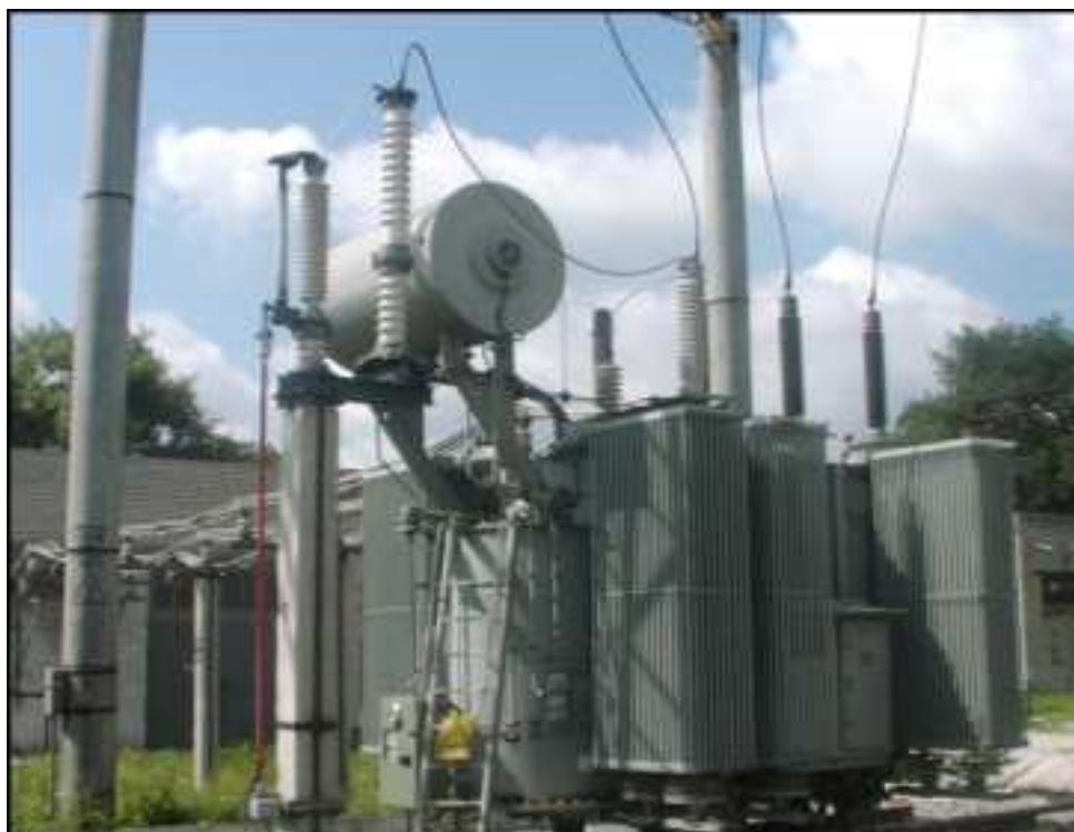
Малюнок 7. Силовий трансформатор на підстанції після проведення реконструкції
