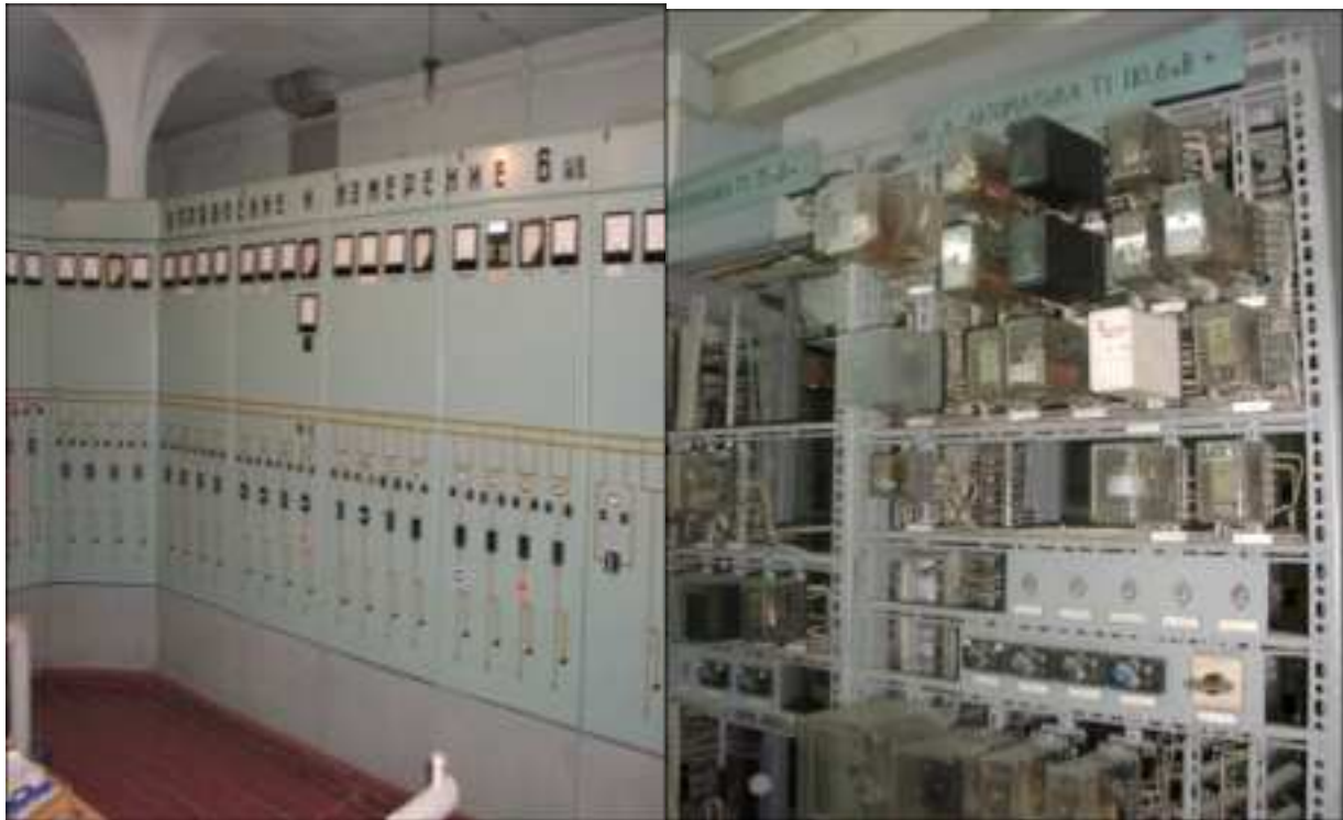
Малюнок 9. Панель керування підстанцією до та після проведення реконструкції.
