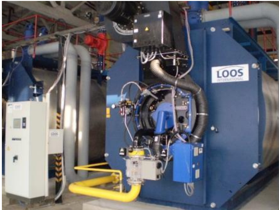
Рис.1. Котли LOOS, встановлені на котельній вул. Ювілейна,117 м.Артемівськ (№152 у проекті)
