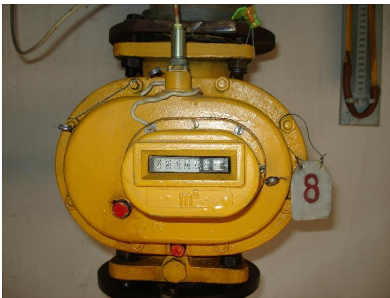
Fig. 3. Gas flow meter
