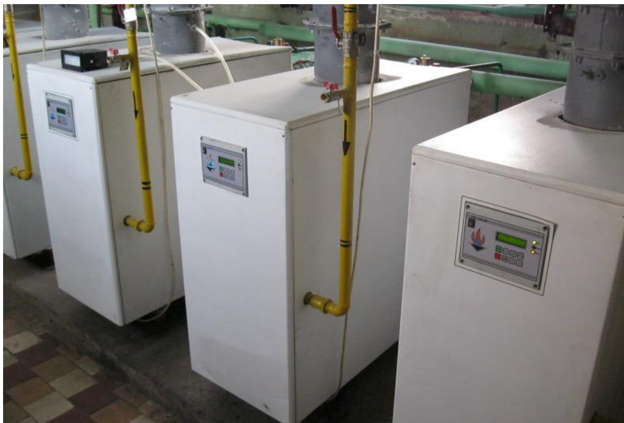
Рис. 1. Котли OVK-100 LWE, встановлені на котельній по вул. Пятисотницька, 19 (№212)
