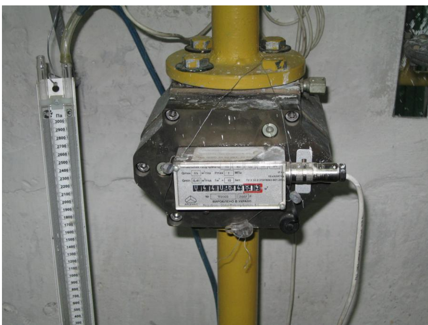
Fig. 3. Gas flow meter
