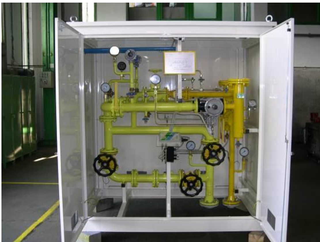
Рис. 6. Шафове обладнання виробництва Італії (Pietro Fiorentini)
