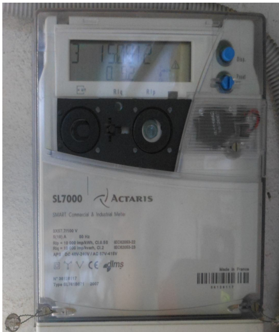
Рисунок 3 – Лічильник електроенергії «Actaris CL7000 Smart»
