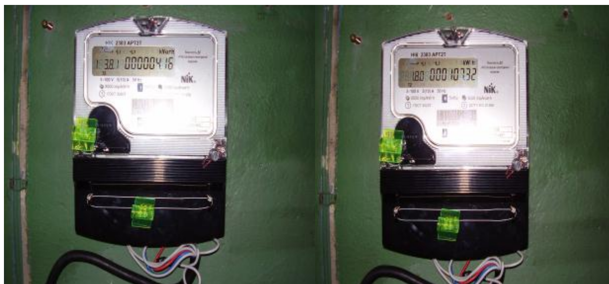
Figure 9 Electricity meter «NIK 2303ART2T»
