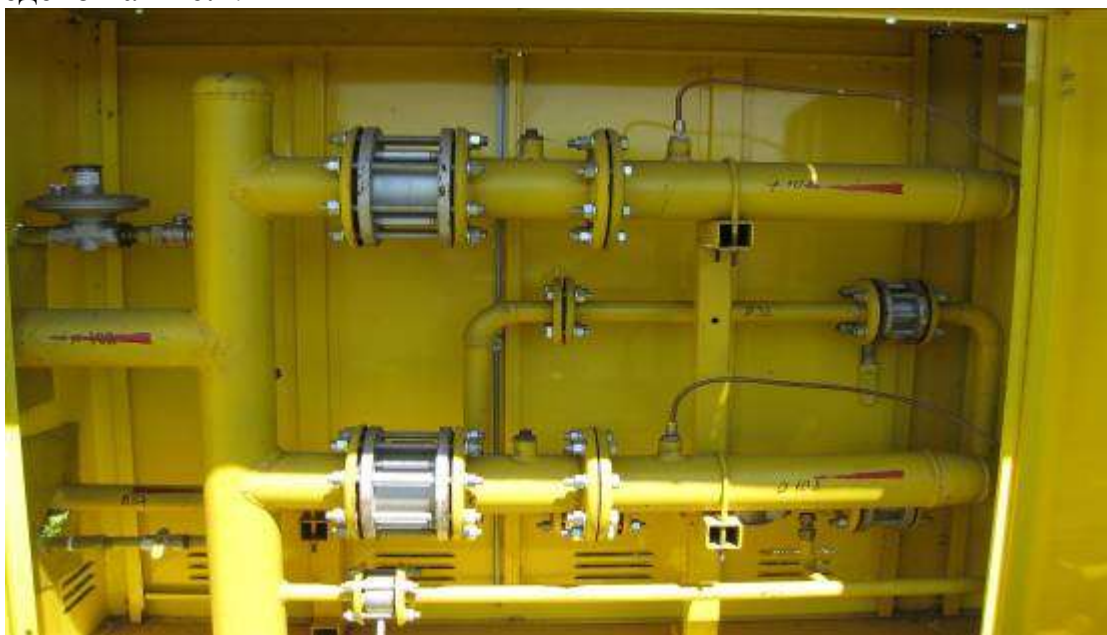
Рис. 1. Відремонтоване ШРП, м. Лубни.
