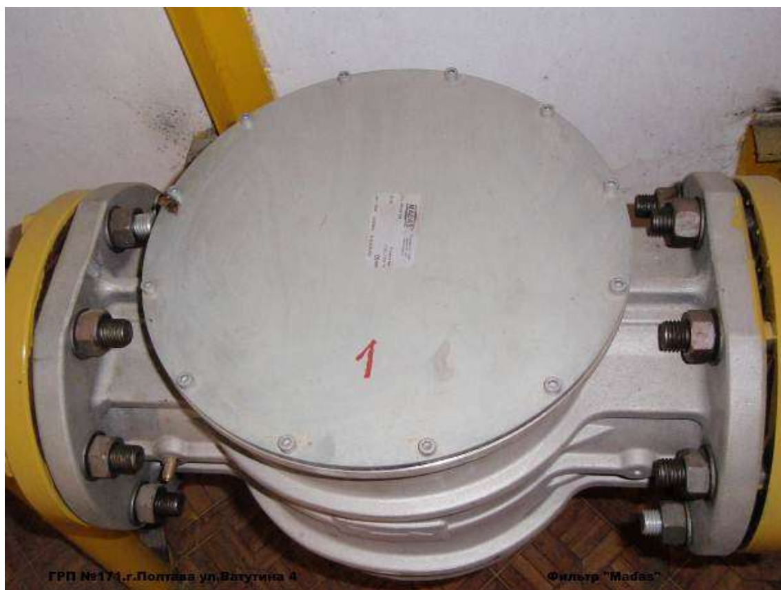
Рис. 2. Замінений фільтр «Madas» у ГРП, реєстровий № 434
