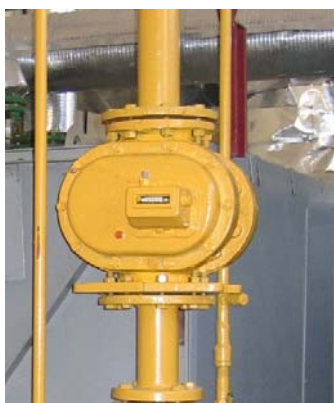
Fig. 3. Gas flow meter
