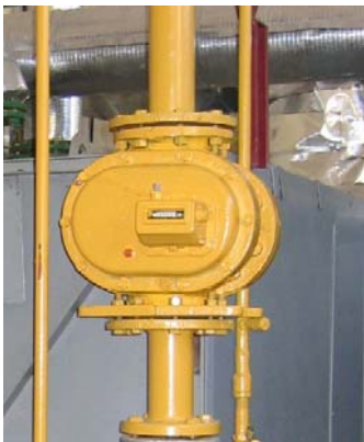
Fig. 3. Gas flow meter
