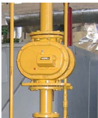
Fig. 3. Gas flow meter
