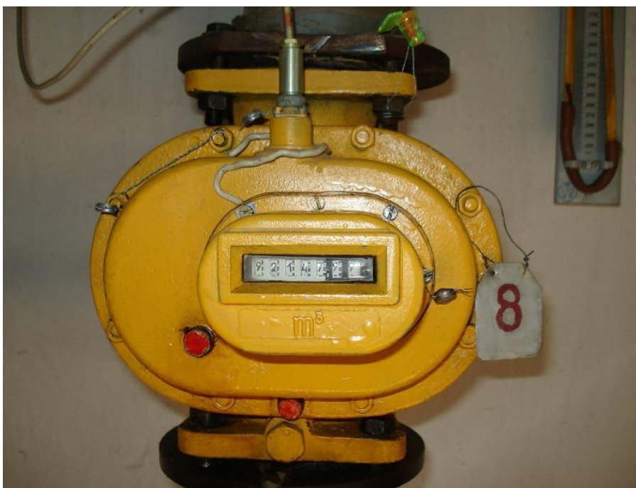
Fig. 3. Gas flow meter
