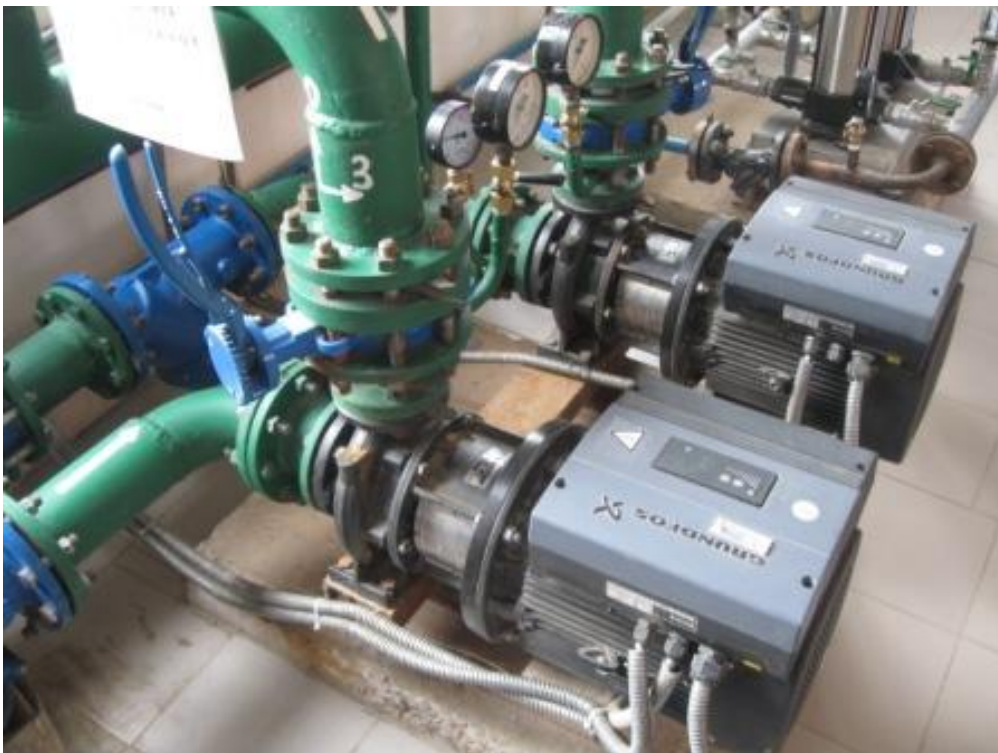
Рис.2 Підвищувальна насосна станція Grundfos CRE1-15 G-A-A-E-HQQE, встановлена на котельні вул. Артема, 4496 (№102 у Проекті)
