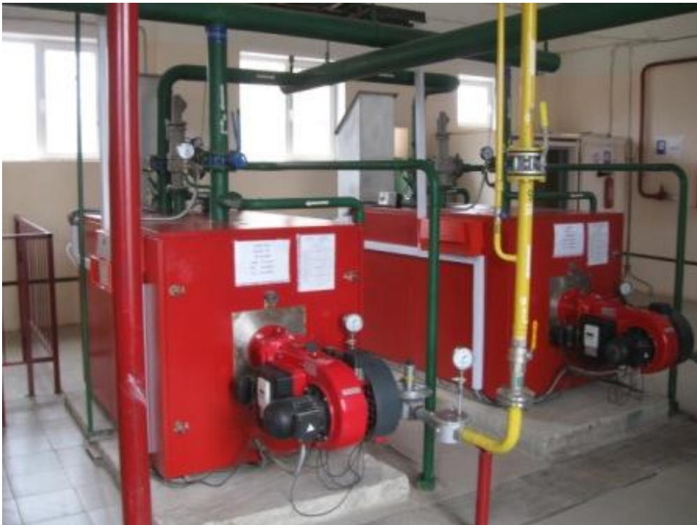
Рис.1 Ктли КОЛВІ-550, встановлені на котельні вул. Артема, 4496 (№102 у Проекті)
