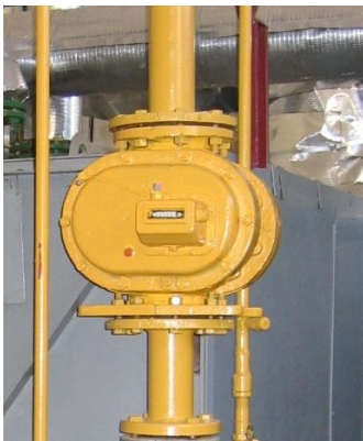
Fig. 3. Gas flow meter
